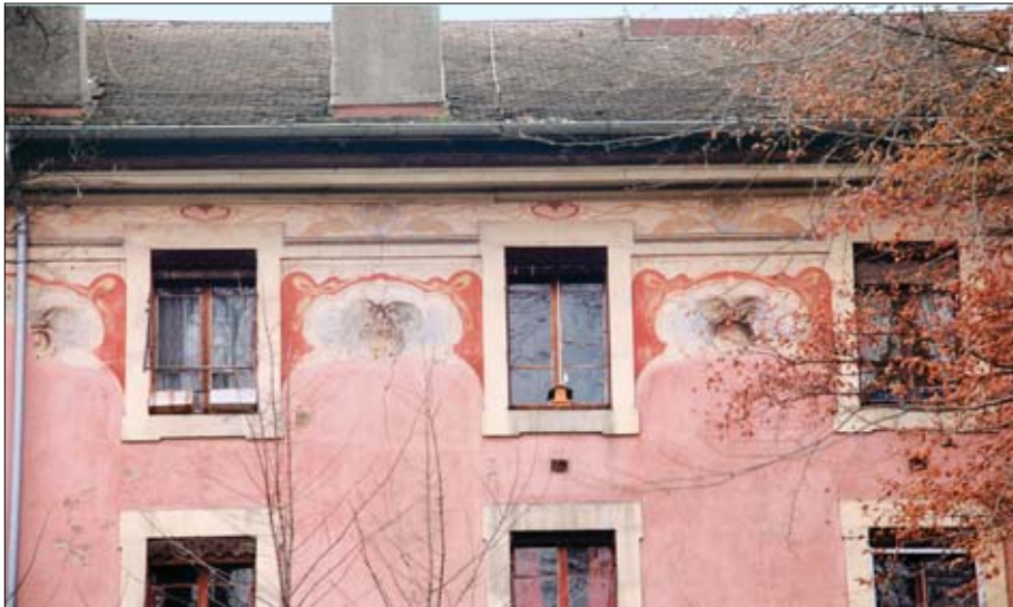
Ornements de façades avant restauration
